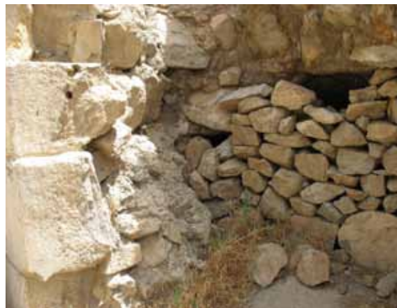
تصویر شماره ۱۸: زیاده‌روی در ملات گچ استفاده شده در زیرسازی نماها
