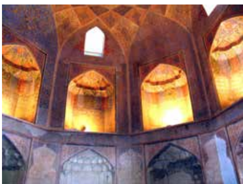
تصویر شماره ۱۹: هنر مقرنس‌سازی گچی در اسکنج‌سازی‌ها و ... کاخ خورشید، دوره نادری، مأخذ: اداره میراث فرهنگی و گردشگری استان خراسان رضوی
